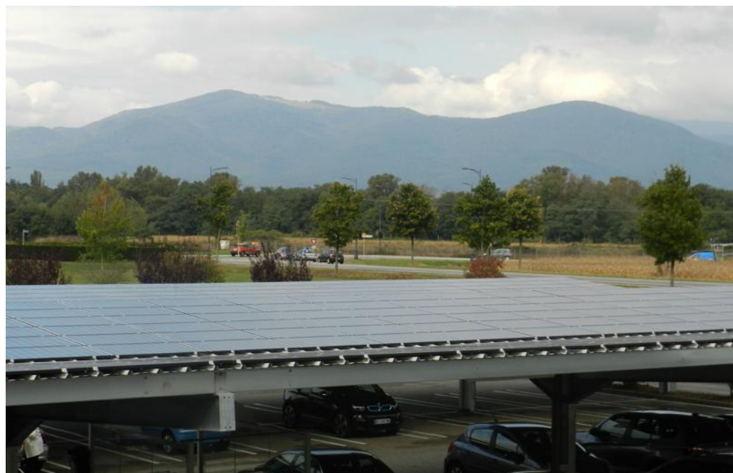
Les ombrières sur le parking qui portent les panneaux photovoltaïques. PHOTO DNA - FZ
