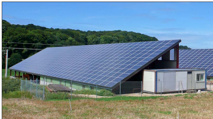
Avec l'installation de panneaux photovoltaïques sur toits plats, Electro Concept Energie dispose d'un potentiel de clients cent fois plus important.
